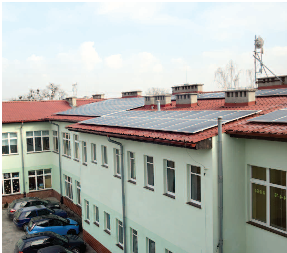
Szkoła w Szewcach z zamontowanymi na dachu panelami fotowoltaicznymi
